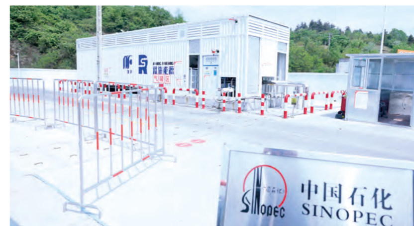
▲ 贵州加气走廊项目
