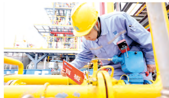
▲ 建设者检查资页8井口零散气回收利用项目装置现场盲板。
